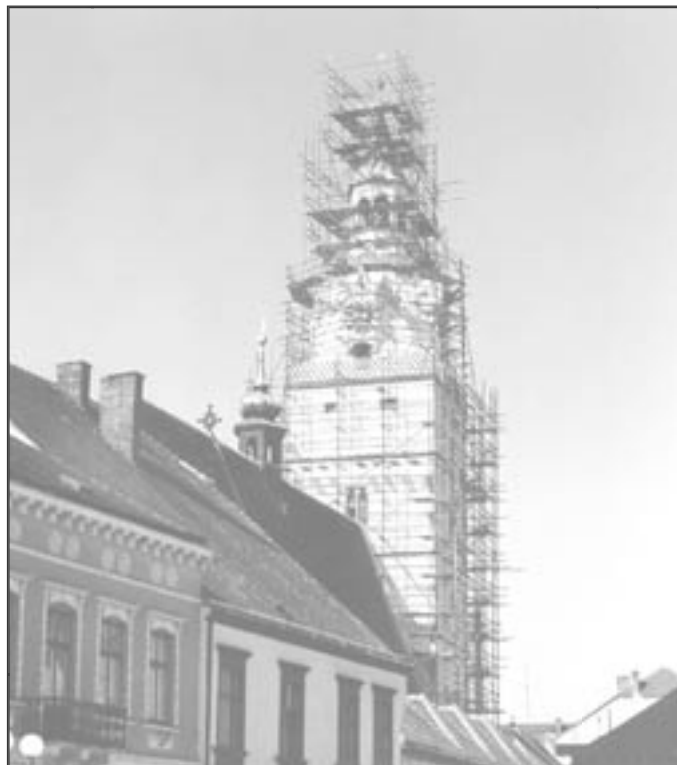
Věž obepruta lešením při opravě v roce 1993
